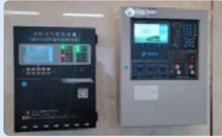
数据中心消防系统
